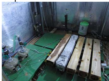
木材乾燥室内部
